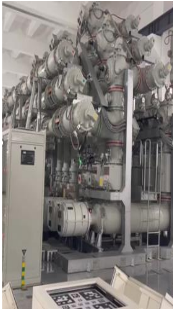
室内変電所設備の巡回検査
